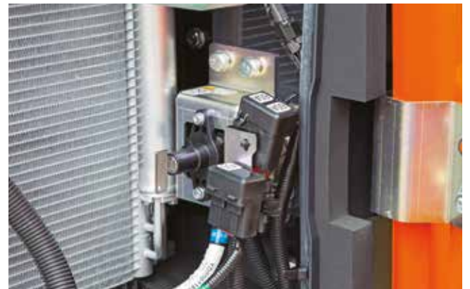
Hovedstrømbryteren gjør at vedlikeholdet kan utføres på en trygg måte.
